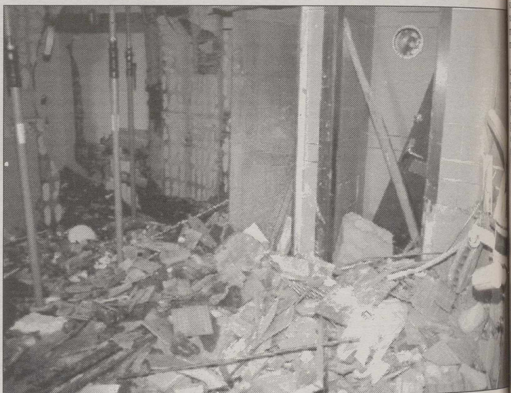
La bomba desactivada estaba colocada en un falso techo de los lavabos de la cafetería.
