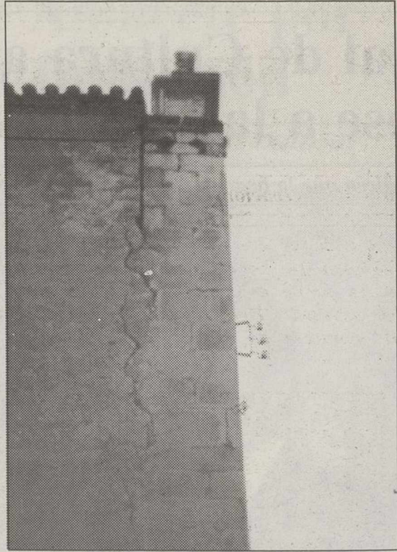
La iglesia de Santa Catalina acusó el terremoto
