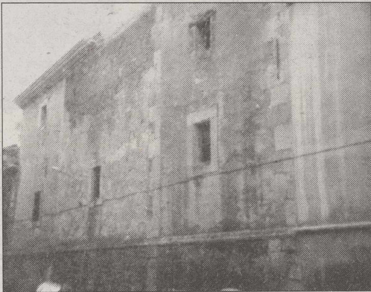
El desplome destruyó un coche estacionado
