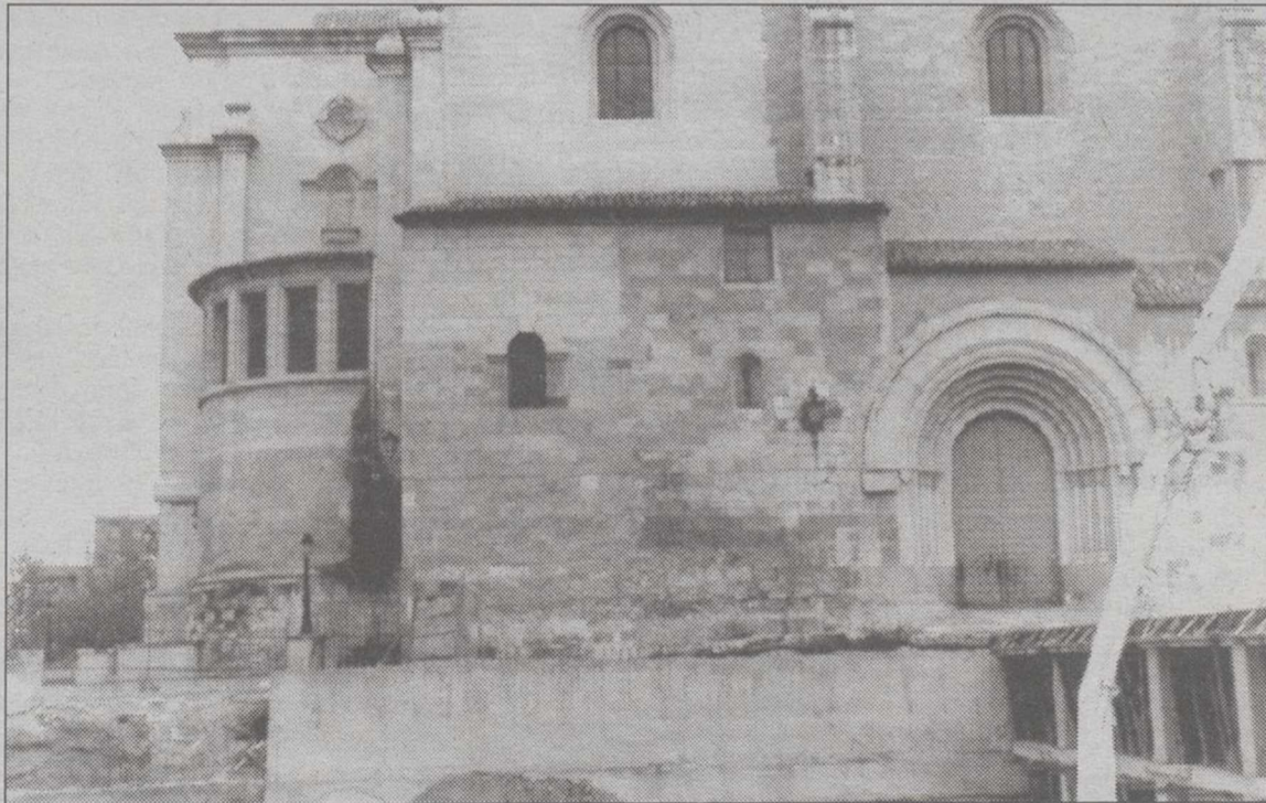
(Pág. 5) El tramo de sillería que se va a ocultar será de un metro en su parte más alta y próxima a la entrada principal del edificio.
