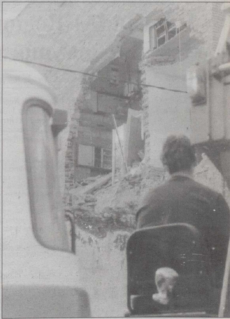
Así quedó el tabique izquierdo, junto al solar colindante.
