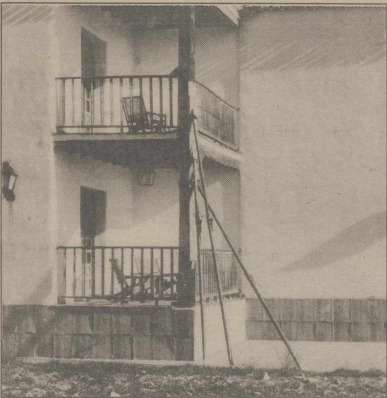
Las balconadas han sido apuntaladas.
