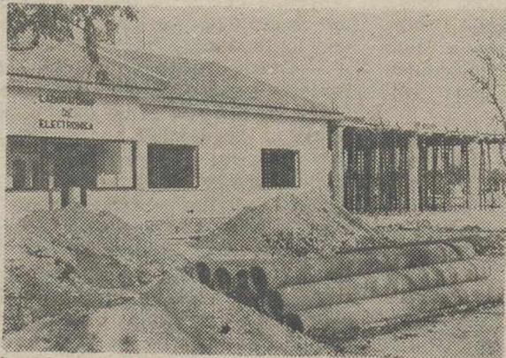
La Maestranza, en obras de ampliación. Pronto contará con un magnífico laboratorio de electrónica. (Foto José Luis).
