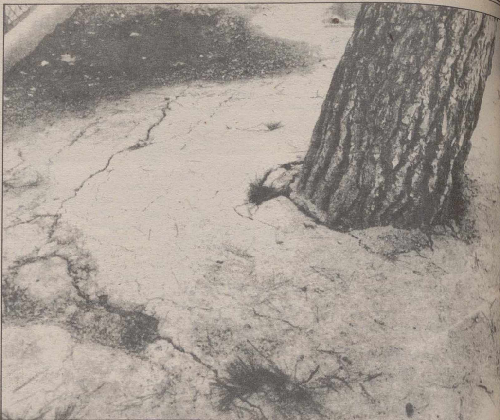
LAS RAICES SON PROFUNDAS, PERO... Algunos árboles del parque ofrecen este aspecto, en su base, como si fueran edificios agrietados. Las raíces son profundas, pero toda precaución es poca ante los aires que han corrido estos días. (Foto Luis Miguel)
