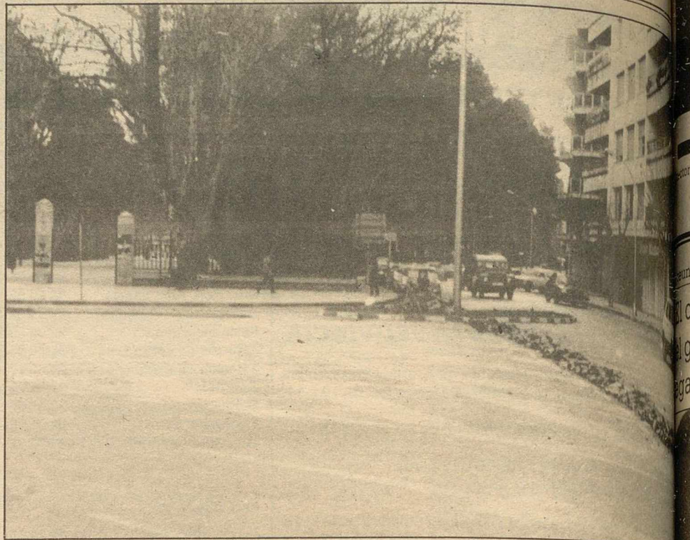
OBRAS EN "LA PUNTA".—En "la punta" del Parque de Abelardo Sánchez se hacen obras, con levantamiento del asfalto. Normalmente, en las obras urbanas se pide perdón por las molestias a los peatones. Aquí habrá que pedirselas a los automovilistas.—(Luis Miguel)
