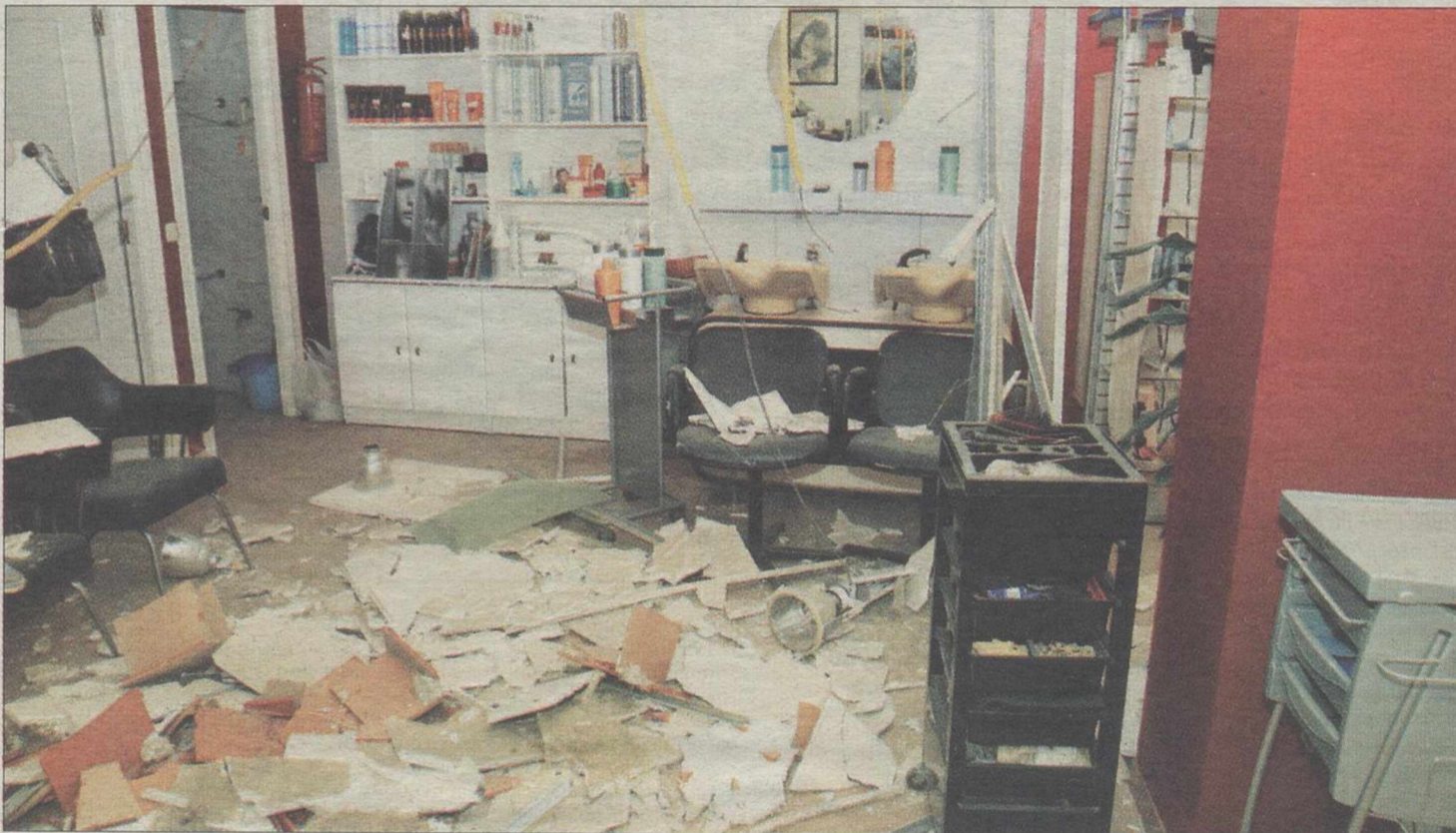
El techo de una céntrica peluquería de Ciudad Real cayó sobre una cliente y dos trabajadoras sin causar daños personales, el pasado jueves. / T. FERNÁNDEZ
