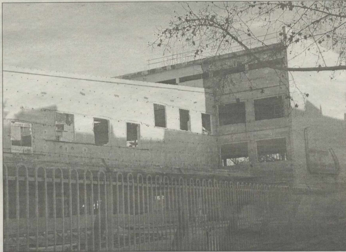
Aspecto actual que presenta las obras de remodelación de la Escuela de ITA
