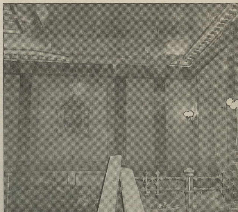
El techo del Salón de Plenos se derrumbó por el peso de la palomina.
