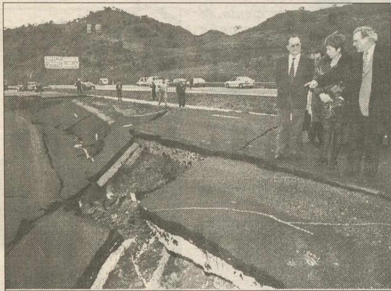
Juan F. Lazcano observa los desperfectos en una carretera andaluza. EFE
