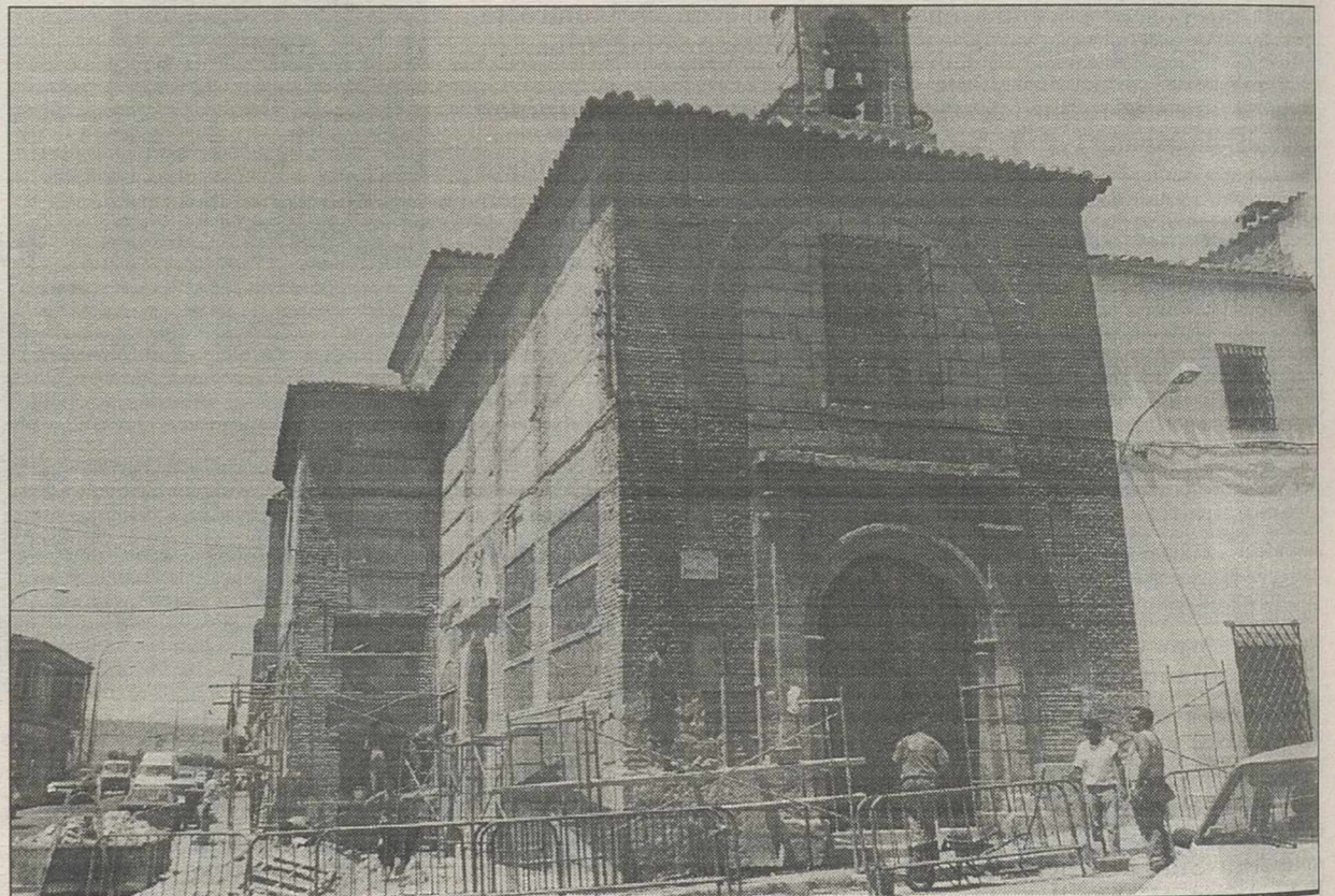
El lugar de celebración ha variado, debido a las obras que se están realizando en el templo del Santo Cristo.
