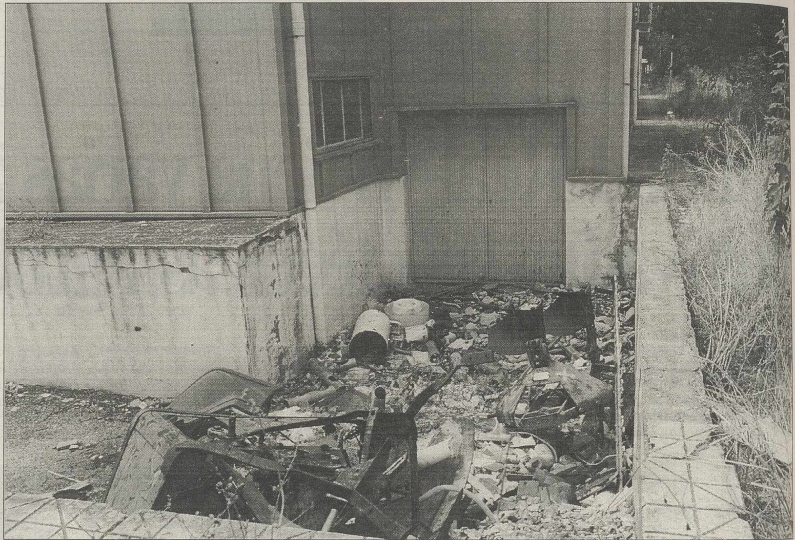
Una de las zonas del edificio del INEM, convertida en un estercolero donde han sido arrojada chatarra y basura.
