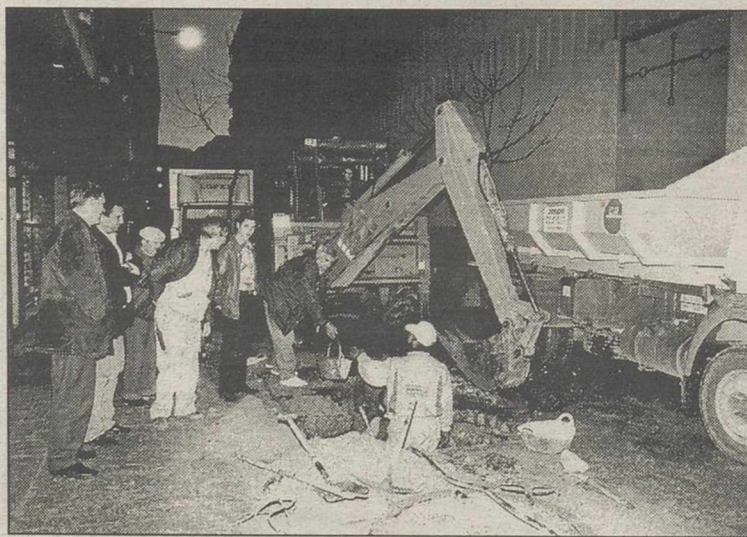
La avería se produjo en la calle Calatrava.
