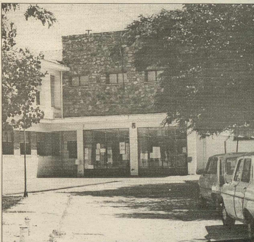
El cierre y desalojo del centro se decidió por las grietas y fisuras aparecidas.
