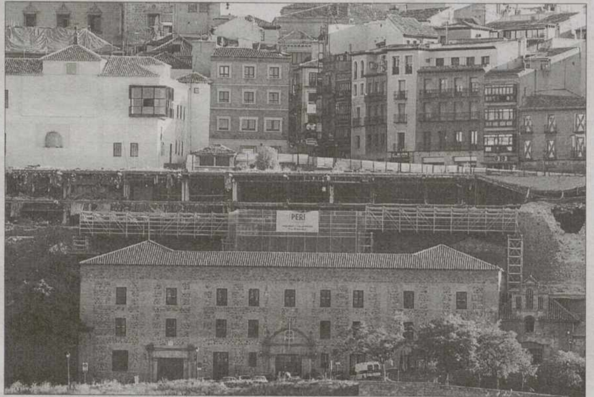
El Ministerio de Justicia apuesta por el traslado de todos los trabajadores de los juzgados de Gerardo Lobo. / VALDIVIELSO
