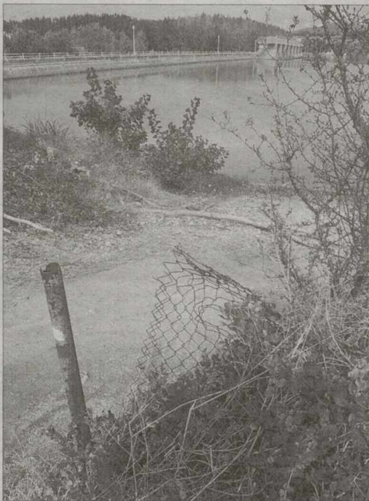
La valla de separación de la carretera necesita ser reemplazada. / R. VIADERO
