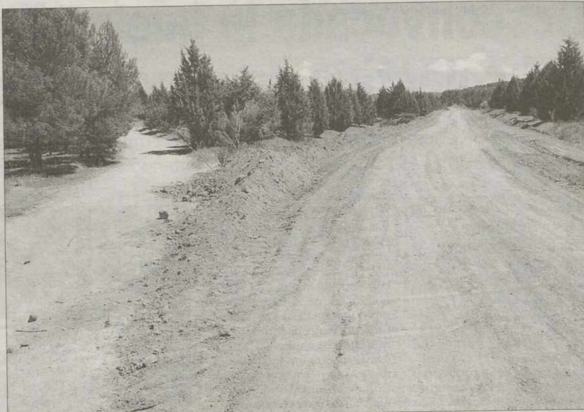
El conflicto sobre la titularidad de los terrenos podría llevar a la paralización de las obras. / YOLANDA LANCHÁ
