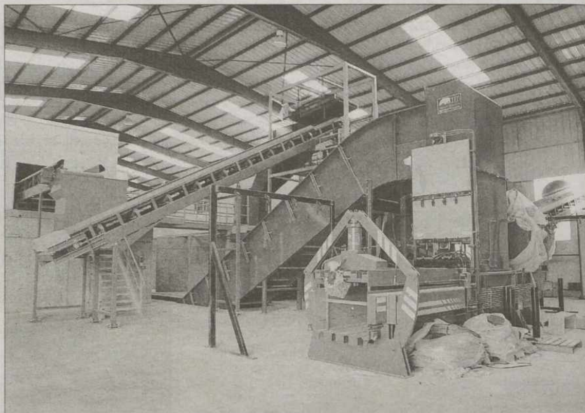
La Planta se mantiene parada mientras no se determine una nueva ubicación para el vertedero. /DAVID PÉREZ
