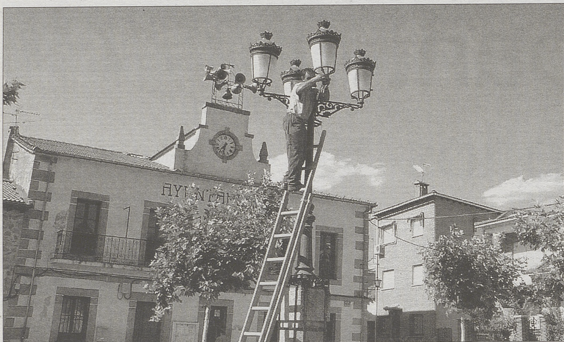
Somocar realiza todo tipo de instalaciones, como se puede apreciar en esta imagen y en la inferior.
