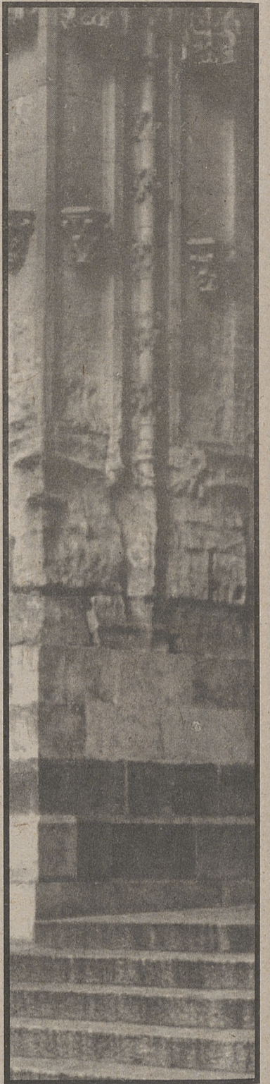
En los bajos se ha colocado un zócalo de granito, sin cortar la piedra, por lo que la humedad sigue sufriendo.
