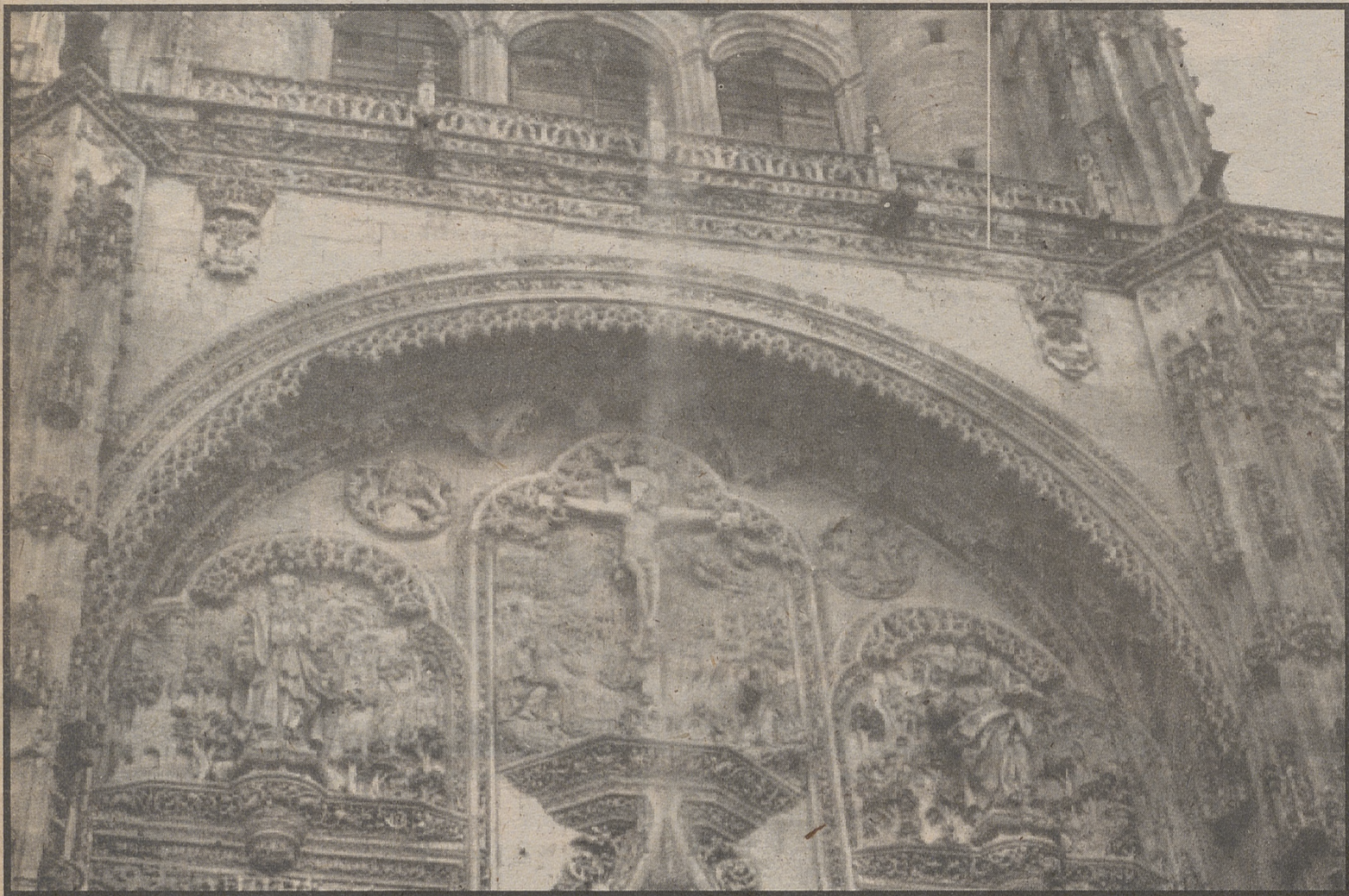
El efecto del agua se observa fácilmente en la portada de la Catedral de Salamanca, la piedra está blanquecina
