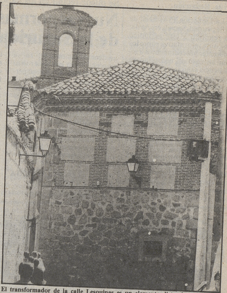
El transformador de la calle Lesquinas es un elemento distorsionante en la misma.
