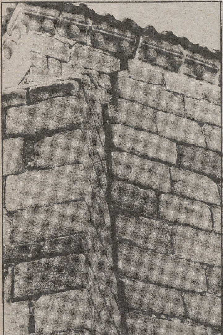
Una gran grieta se ha abierto entre la pared y el contrafuerte.
