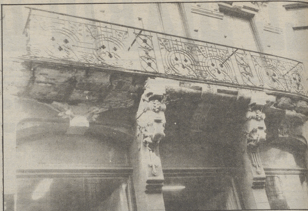
Un nuevo trozo de balcón ha caído en la calle Generalísimo.
