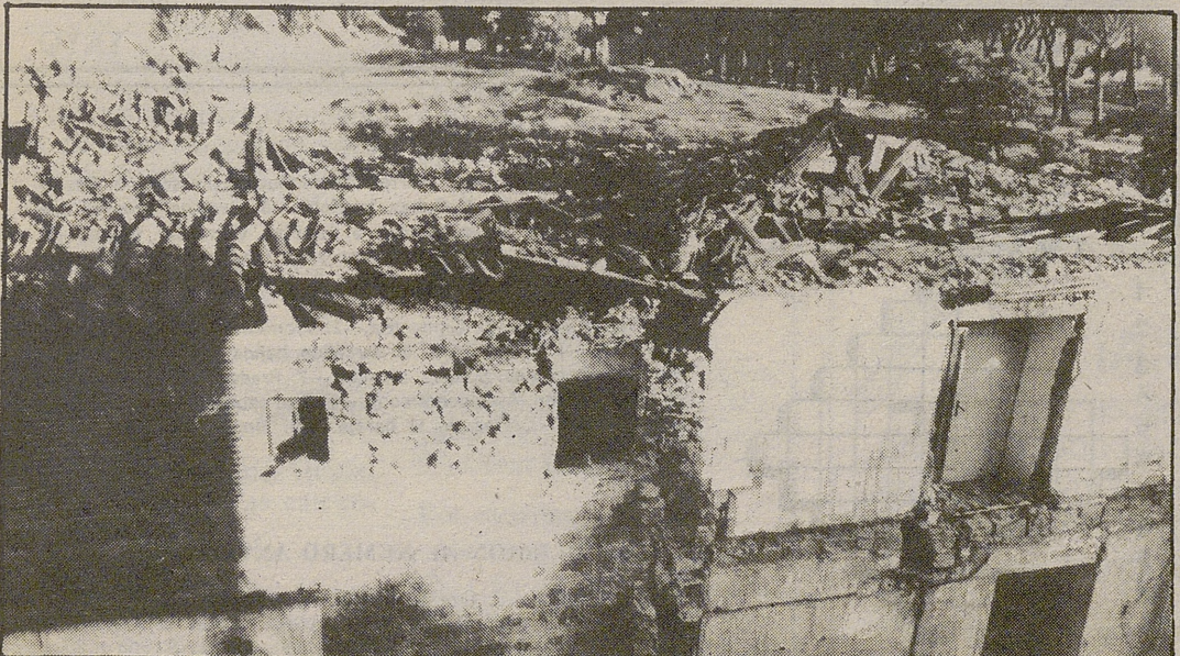
En su actual estado, la cubierta de esas ruínas constituye un peligro
