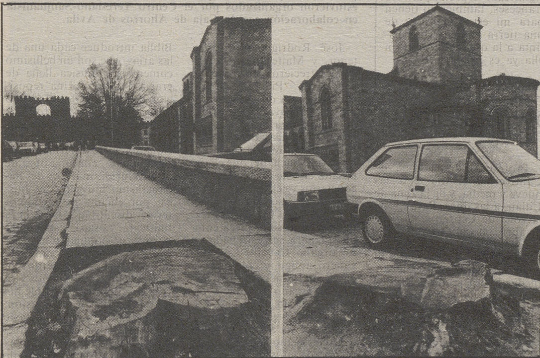
Los tocones sobresalen varios centímetros por encima del pavimento
