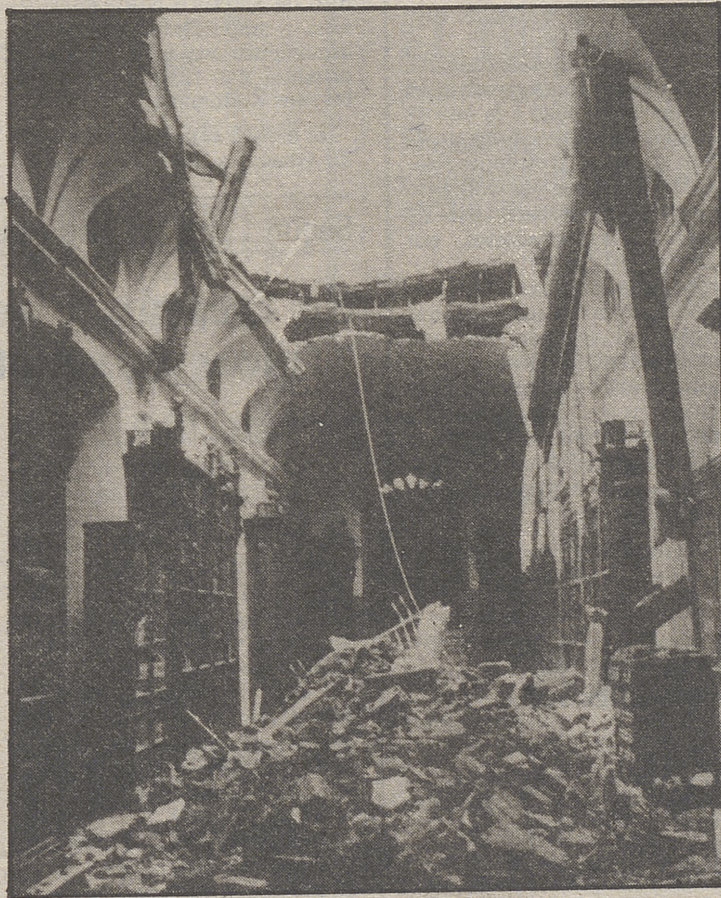
El boquete del techo ha sido cubierto con un plástico para evitar las lluvias. EFE
