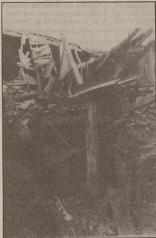
Los restos de la casa hundida han tenido que ser derribados. MAYORAL.
