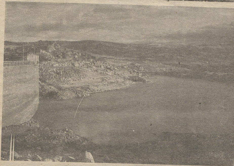
Vista del embalse de Becerril, aguas arriba. Obsérvese que se encuentra prácticamente vacío
