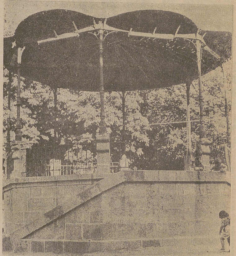
Hace años que este templete muestra el estado de abandono en que se encuentra. Le faltan la totalidad de las barandillas de la escalera y algunas de las que rodean el octógono que forma la pista. En cuanto a la cubierta, ofrece un aspecto lamentable. La verdad es que, para conservarla en el estado en que, desde hace años, se encuentra, mejor sería desmontarla. (Foto: LUMBRERAS).
