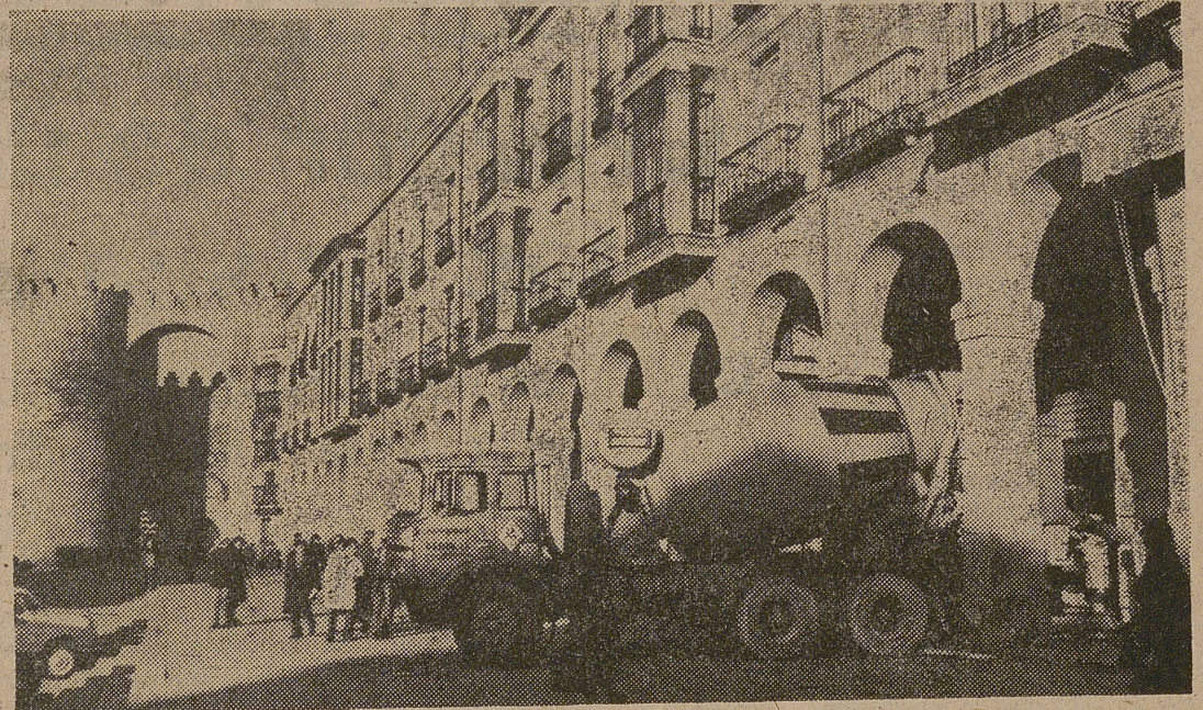
En una de las casas de nuestra popular Plaza del Mercado Grande se están realizando obras de reforma. Ello ha dado ocasión a que, con la presencia de un camión-horgigonera, introducido bajo los típicos soportales, estos ofrezcan al indígena y al ocasional visitante la insólita perspectiva que, tan oportunamente, ha sabido captar, con su cámara, MAYORAL.
