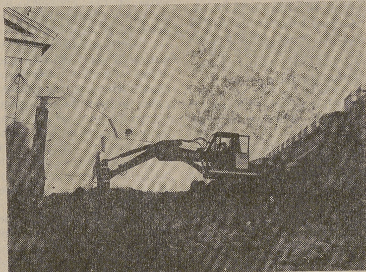
Debido al grave peligro que suponía la situación en que había quedado, ha tenido que ser derribado totalmente el paredón del patio de los PP. Carmelitas, situado entre la Delegación de Hacienda y el Arco de la Santa, y que se había desplomado parcialmente, conforme dábamos cuenta en nuestro número de ayer.—(Foto: MAYORAL).
