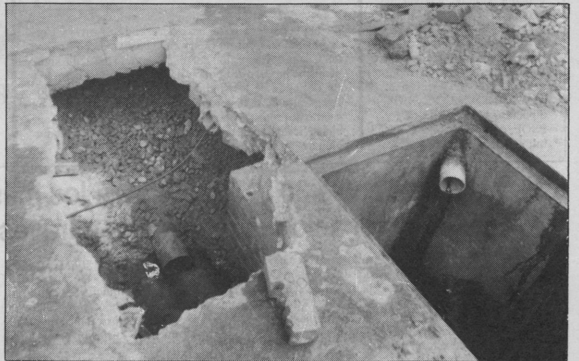
Ayer se descubrió que las arquetas de saneamiento no están conectadas a la red general. FERNANDO PEÑALOSA
