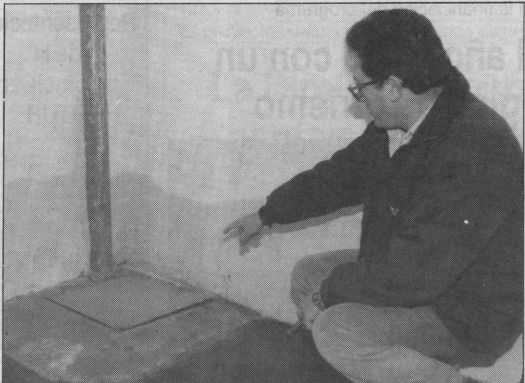
Uno de los propietarios muestra uno de los sumideros de saneamiento atascados.
