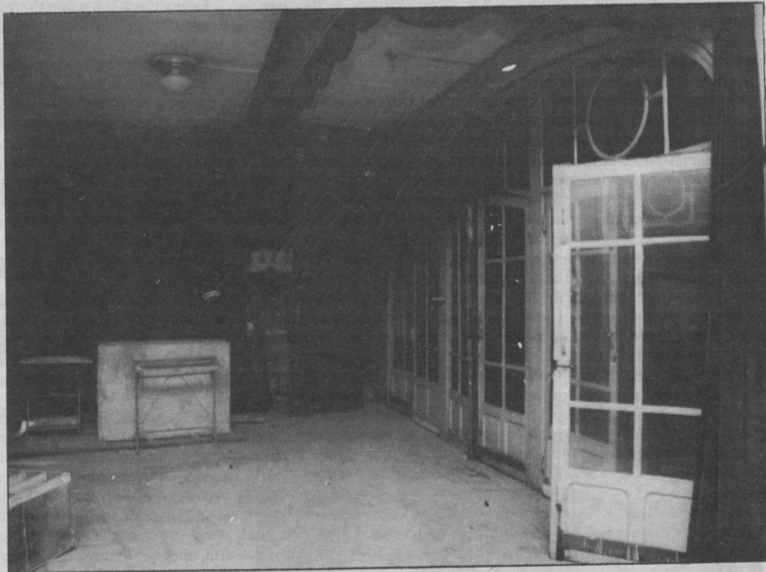
El abandono del edificio es especialmente considerable en la mayor parte de sus zonas.
