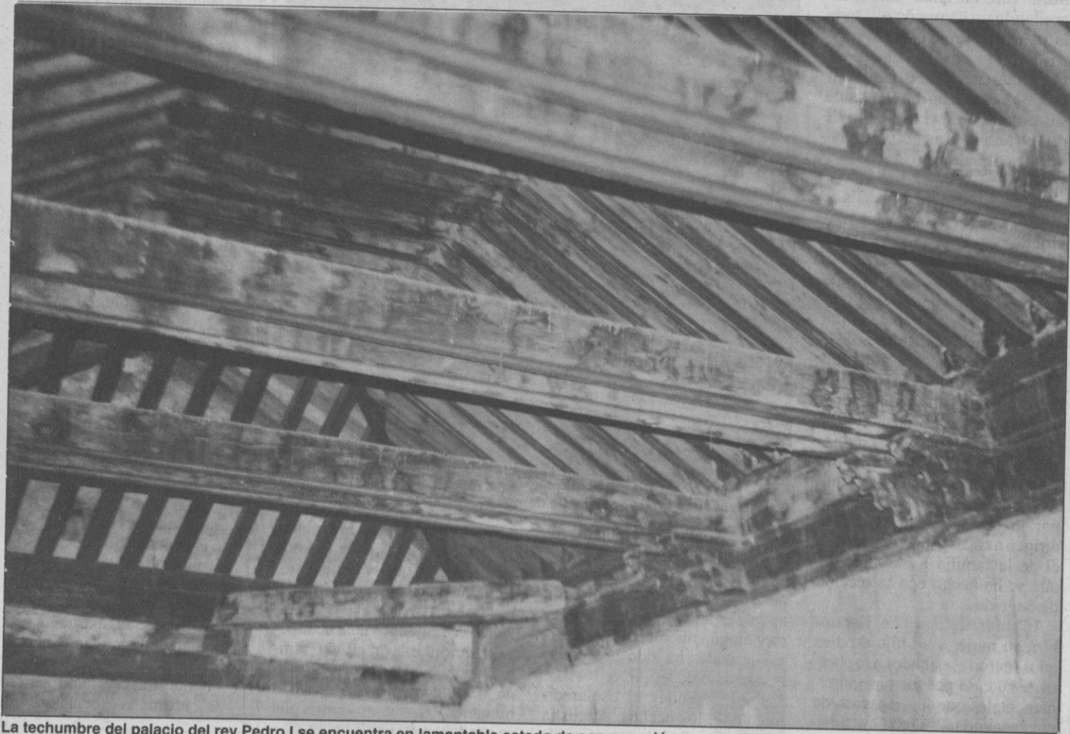
La techumbre del palacio del rey Pedro I se encuentra en lamentable estado de conservación.
