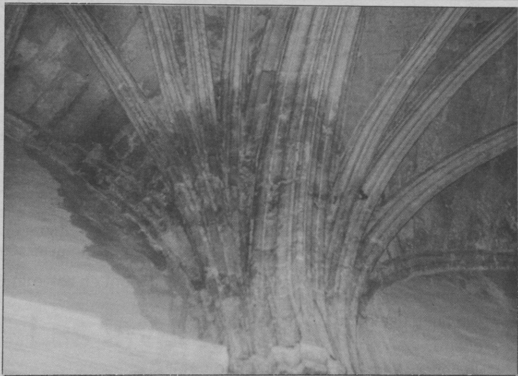
La gotera más importante está en el arranque de los nervios del pilar situado al lado del evangelio. S. GUIJARRO
