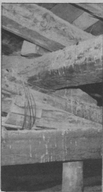
Estado de la cubierta. S. GUIJARRO
