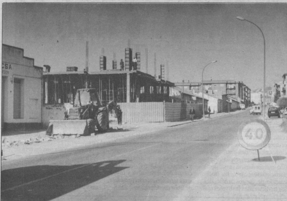
La avenida de Camino José Cela, en una de las fases de pavimentación.
