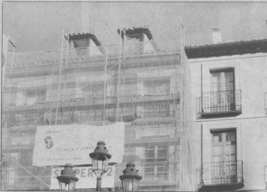
La rehabilitación de fachadas y edificios preocupa a los alcaldes de las ciudades Patrimonio.
