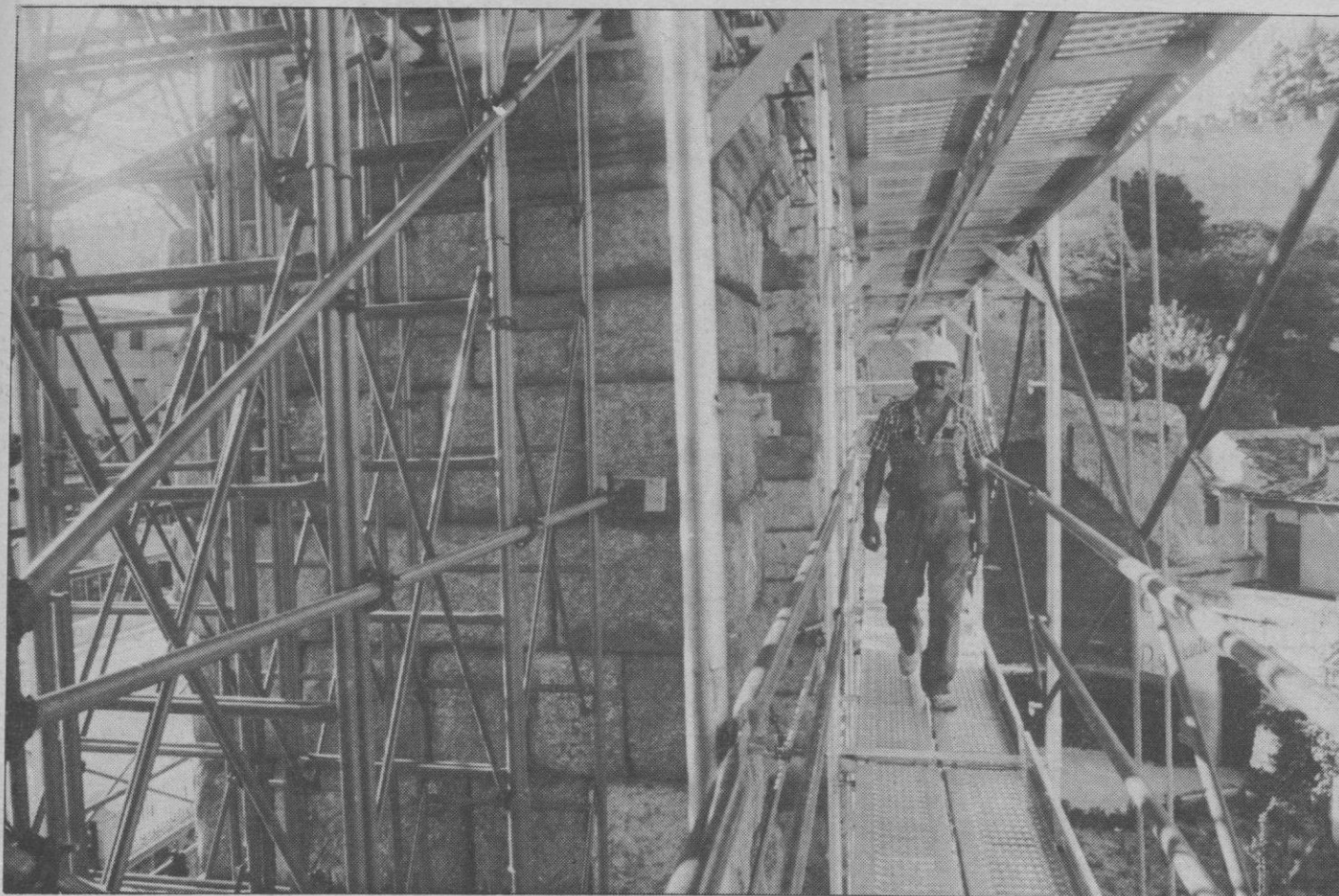
El andamio está considerado como un elemento de trabajo para comprobar el estado de la obra romana, desde varias alturas.
