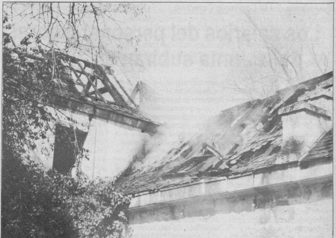
Estado en que ha quedado la cubierta tras el incendio.
