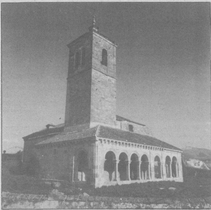
Los daños afectan fundamentalmente al interior del edificio
