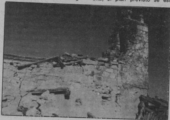
Estado lamentable en el que se encuentra la iglesia-palacio.
