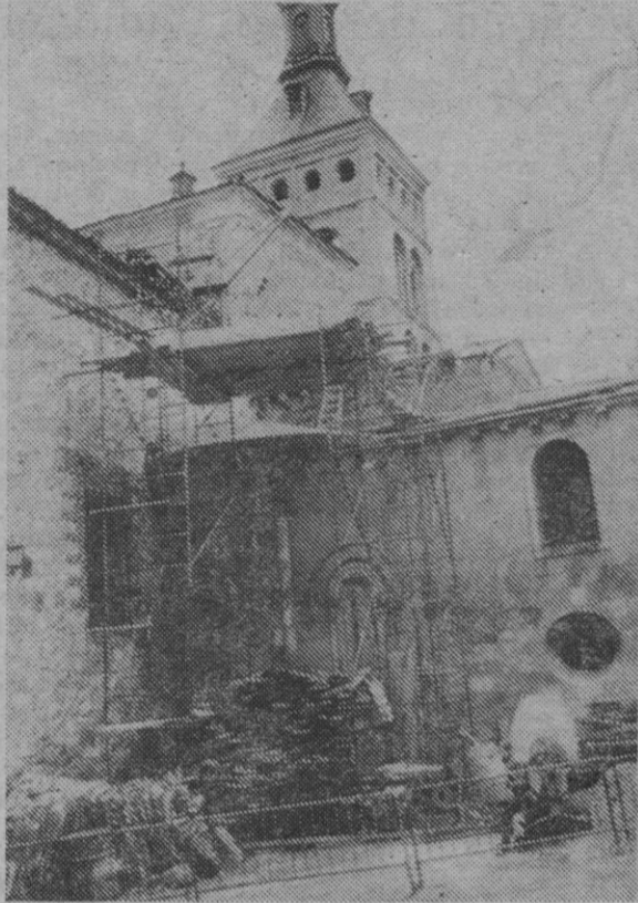
Las cubiertas; la parte más afectada
