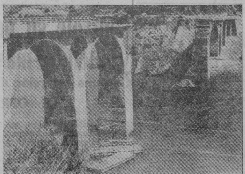
El puente sobre el embalse de Luna, en León, se hundió hace unos días, dejando incommunicados a varios pueblos de las cercanías. La foto nos muestra el estado en que quedó dicho puente.
