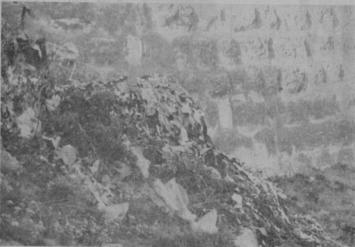
Plásticos, pepes, basura, en fin, junto a los cimien tos del puente, bajo el que discurre el arroyo de Tejadilla
