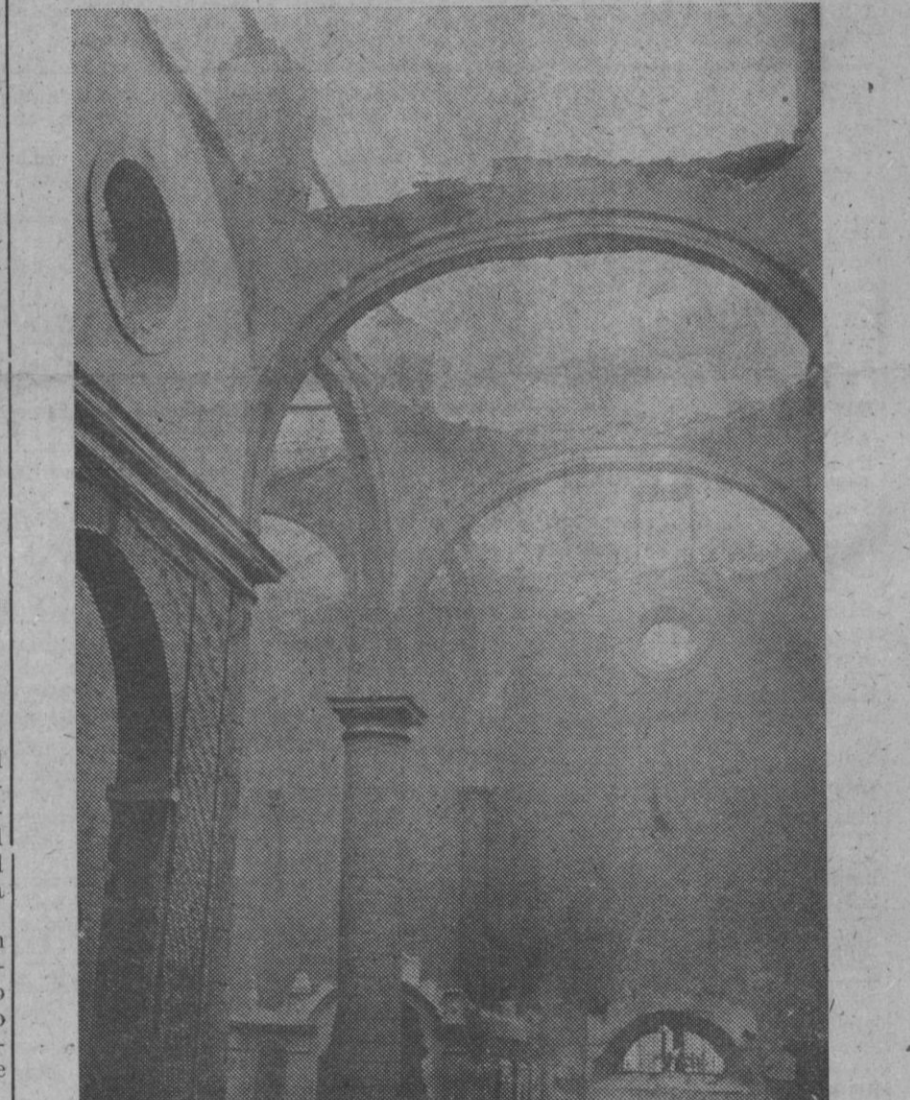
Peñaranda de Bracamonte (Salamanca).—Estado en que quedó la iglesia de San Miguel después de ser destruida por el fuego. A pesar de los esfuerzos del vecindario, de la Guardia Civil y de los bomberos de Valladolid y Avila, el fuego no pudo ser sofocado y se derrumbó la techumbre.—(Foto Europa Press)
