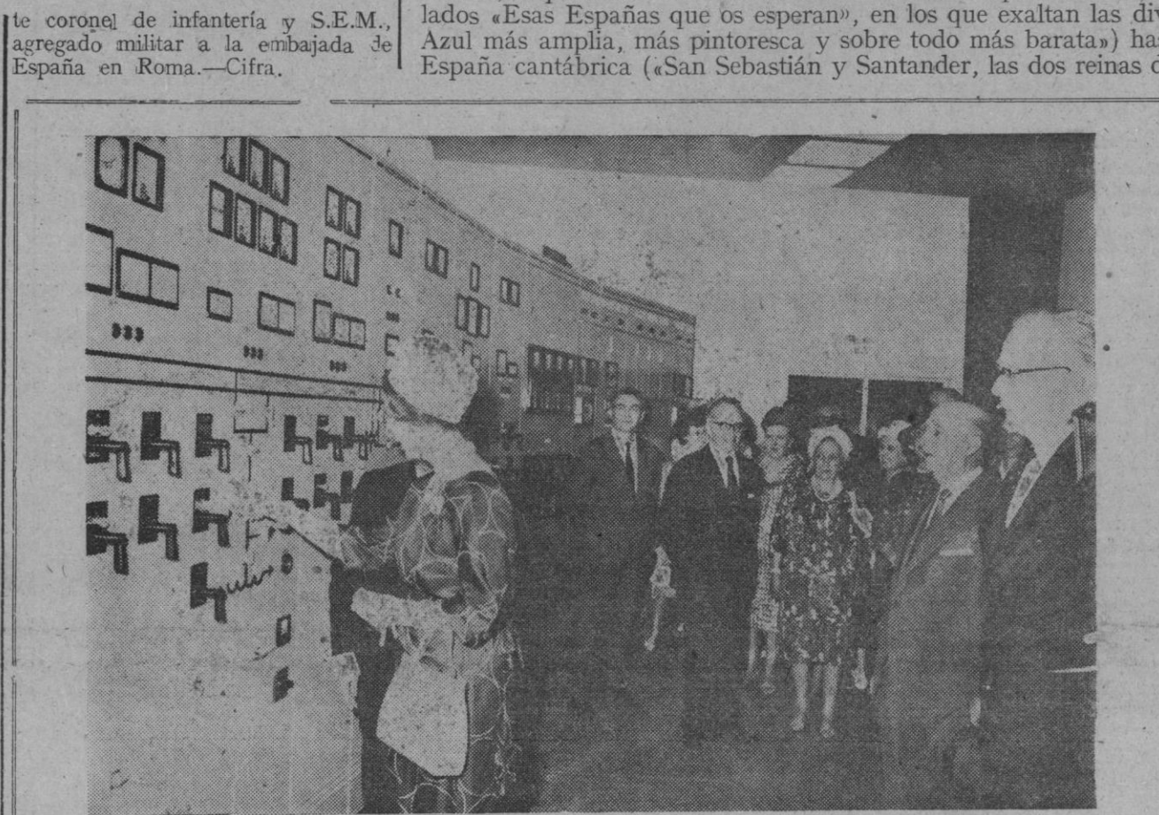
Momento en que la esposa del Jefe del Estado, doña Carmen Polo de Franco, pulsa el botón que puso en funcionamiento la central hidroeléctrica del embalse de Valdecañas, inaugurado por el Caudillo. (Foto Fiel)
