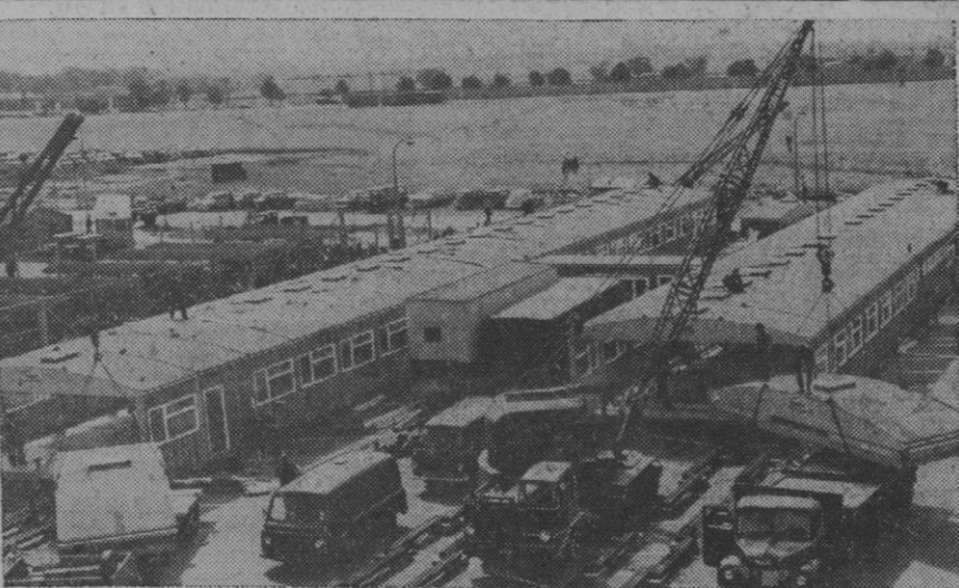
En el aeropuerto de Londres se construyó recientemente en doce horas un edificio para oficinas, que ocupa una superficie de 1.026 m 2 . El edificio quedó completamente terminado, con decorado, instalaciones de agua y alumbrado y listo para ser ocupado. Sirve de alojamiento a cien técnicos de la British European Airways. En la construcción se emplearon cincuenta y siete unidades preparadas de antemano, una de las cuales se ve en esta fotografía en el momento en que una grúa móvil la coloca en posición. Cada unidad pesaba 3,5 toneladas y estaba compuesta de piso, techo y tejado en una pieza y paredes plegables. En la erección trabajaron dieciséis hombres, terminando la obra dos horas antes del plazo fijado.
