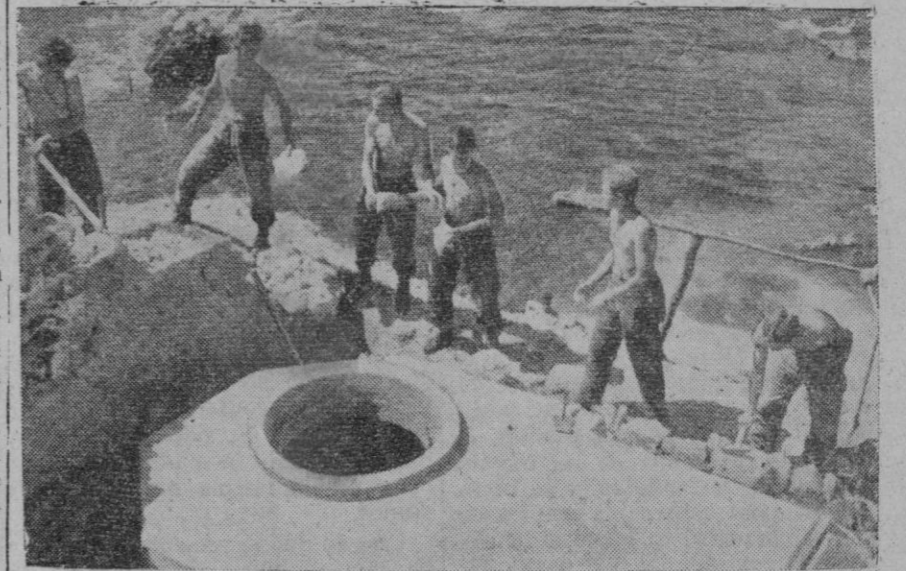
Soldados alemanes del Servicio del Trabajo durante la construcción de fortines en la costa del mar Mediterráneo
