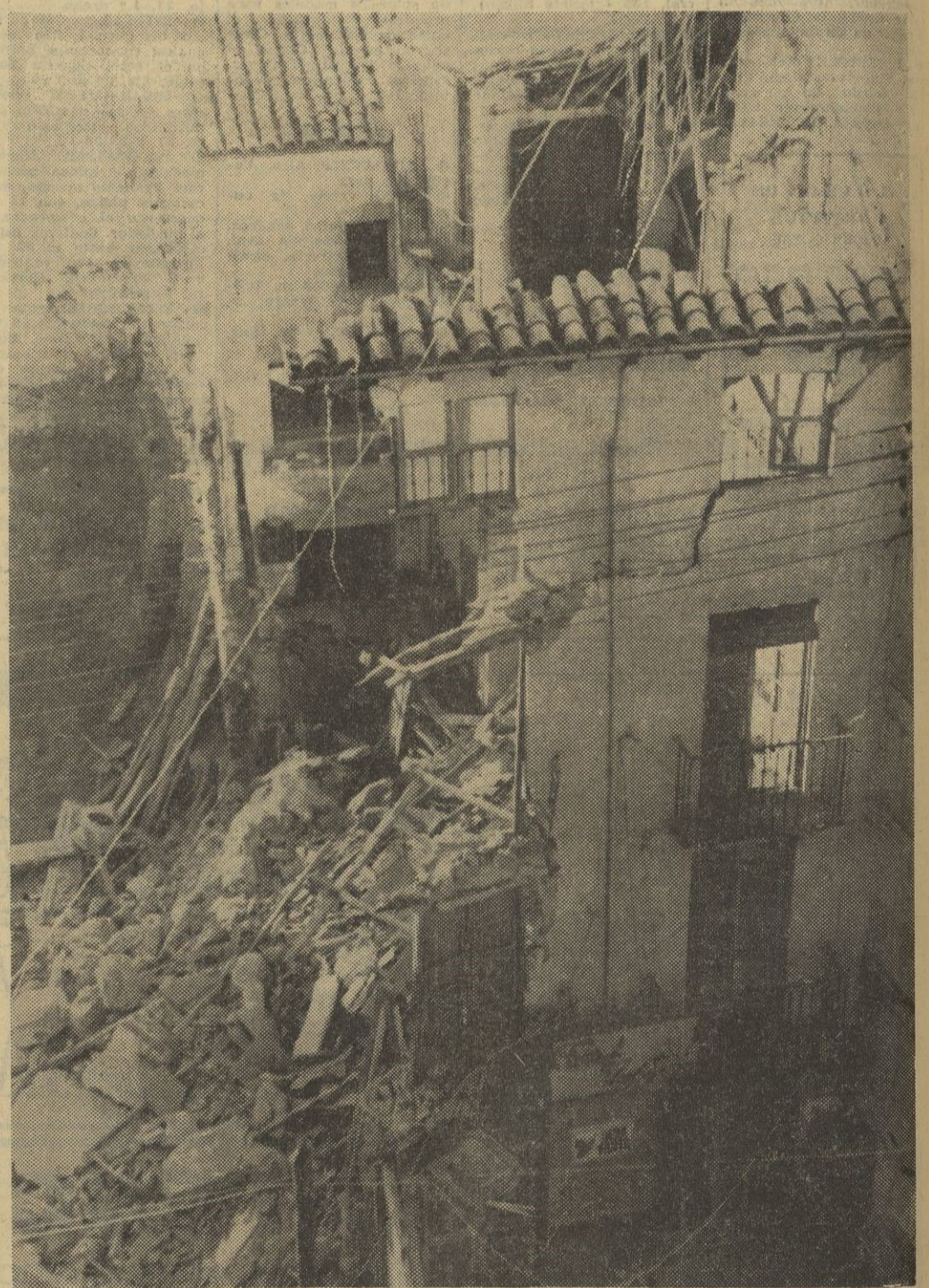
LA CAFETERIA, AL SUELO En la ciudad de Jaén, el edificio de una cafetería, que se encontraba rebosante de personal en aquellos momentos, se ha derrumbado, sin que haya que lamentar víctimas. Se trata del bar Taxi, que ha sufrido los efectos de su aislamiento al haber sido derribado hace poco el edificio contiguo. (Foto Europa Press.)
