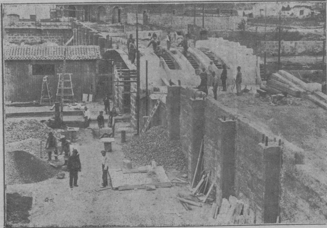
Paso superior de arco rebajado armado y rampas de acceso de la calle de Jacinto Verdaguer, obra proyectada y dirigida por el ilustrado ingeniero Sr. García Ruiz
